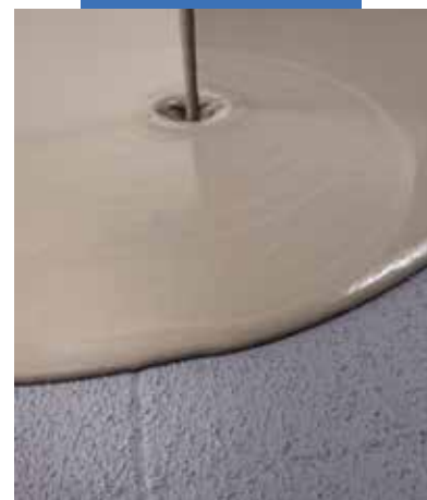
Rozprowadzanie masy samopoziomującej Ultraplán na suchy Eco Prim Grip Plus naniesiony na starą okładzinę
